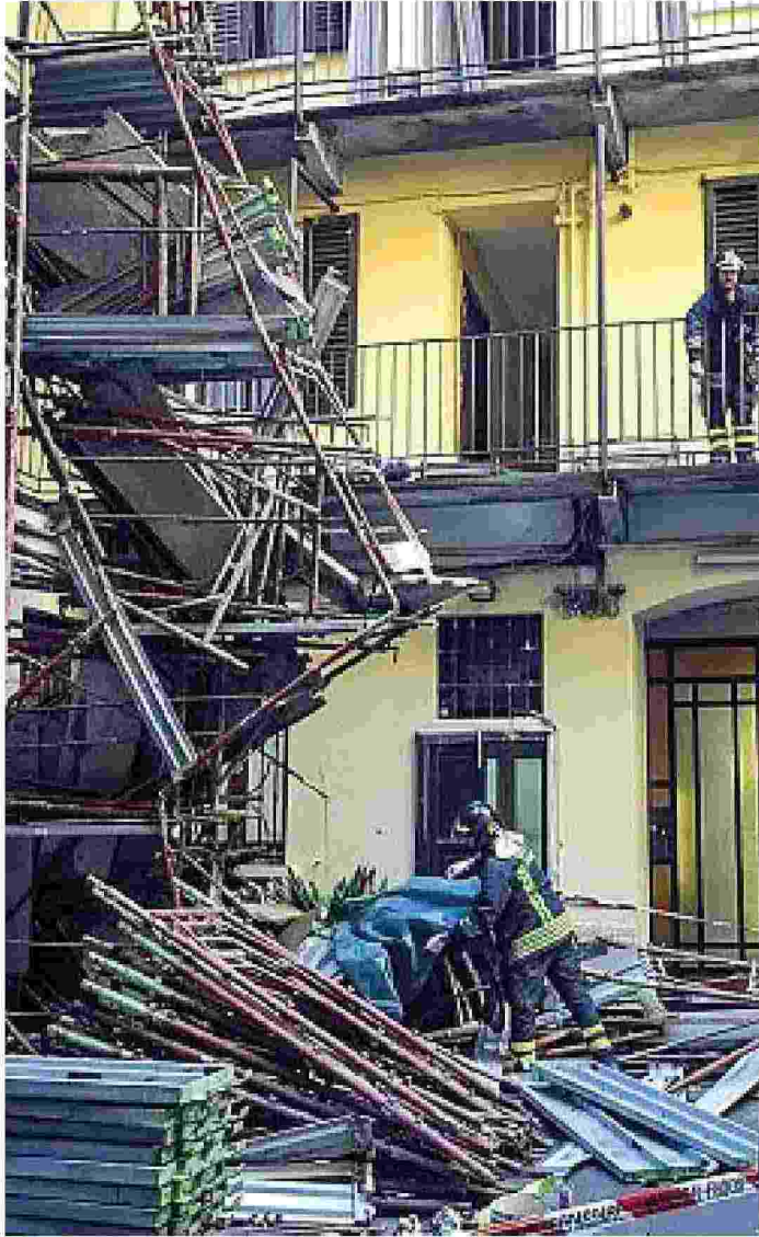
L'incidente Il muratore stava lavorando al quarto piano (LaPresse)
